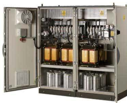
تابلو فیلتر هارمونیک
