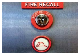
شکل ۶-۳۰- نمونه ای از کلید آتش نشانی
