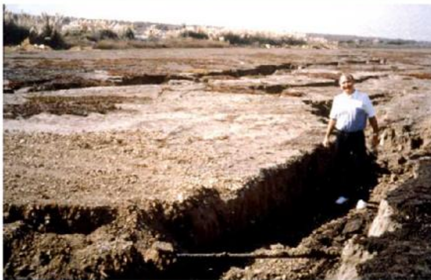
شکل ۲-۵- فرورفتگی زمین در اثر وقوع گسترش جانبی در طی زلزله‌ی سال ۱۹۸۹ Loma Prieta
