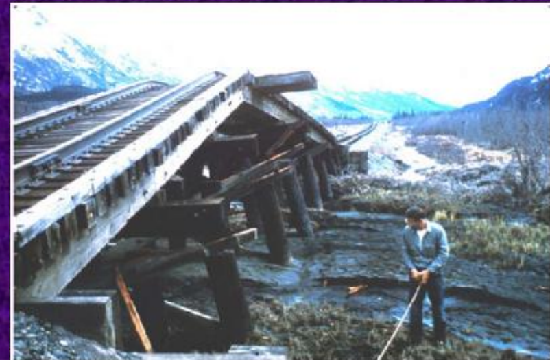
شکل ۱-۴- خرابی پل راه‌آهن واقع بر روی دریاچه‌ی Kenai در طی زلزله‌ی آلاسکا
